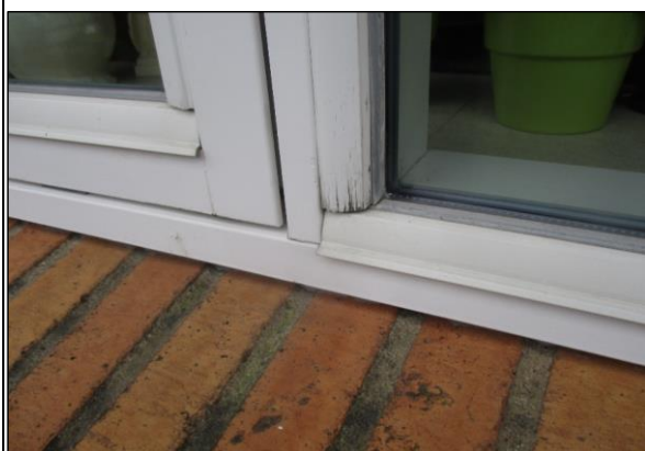
Billede 3: Opfugtning af glaslister v. vinduer
